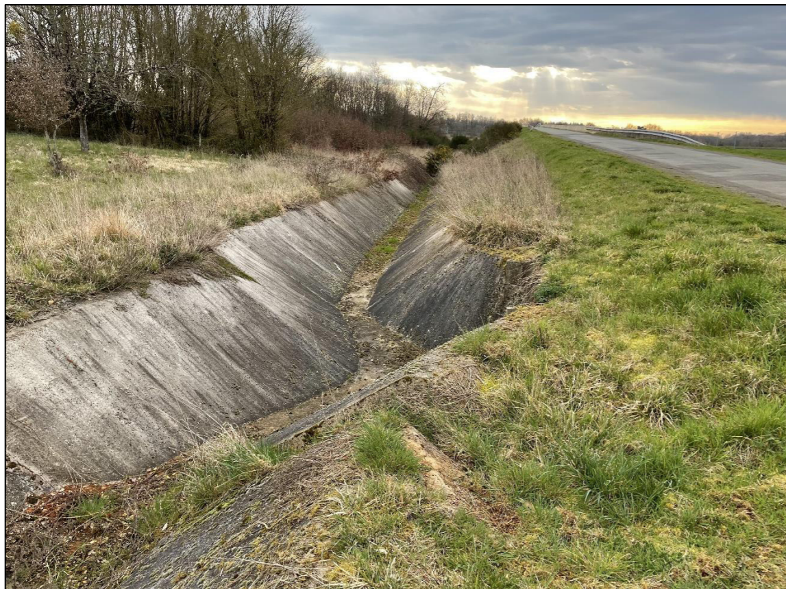
Prise de vue B : Vue sur un ouvrage d'évacuation d'eaux pluviales au nord du site d'étude
